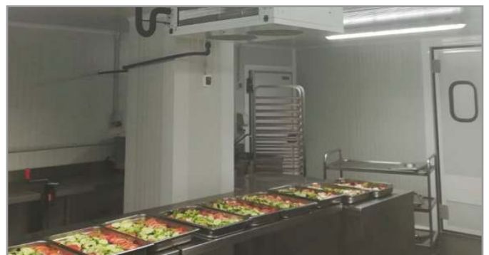
12 Detalle Zona Cuarto Frío
